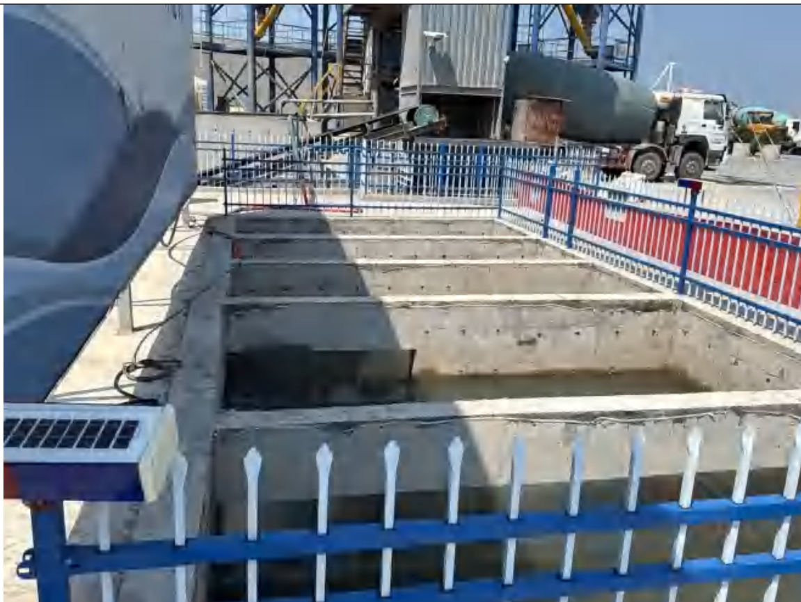
废水沉淀池组 1
