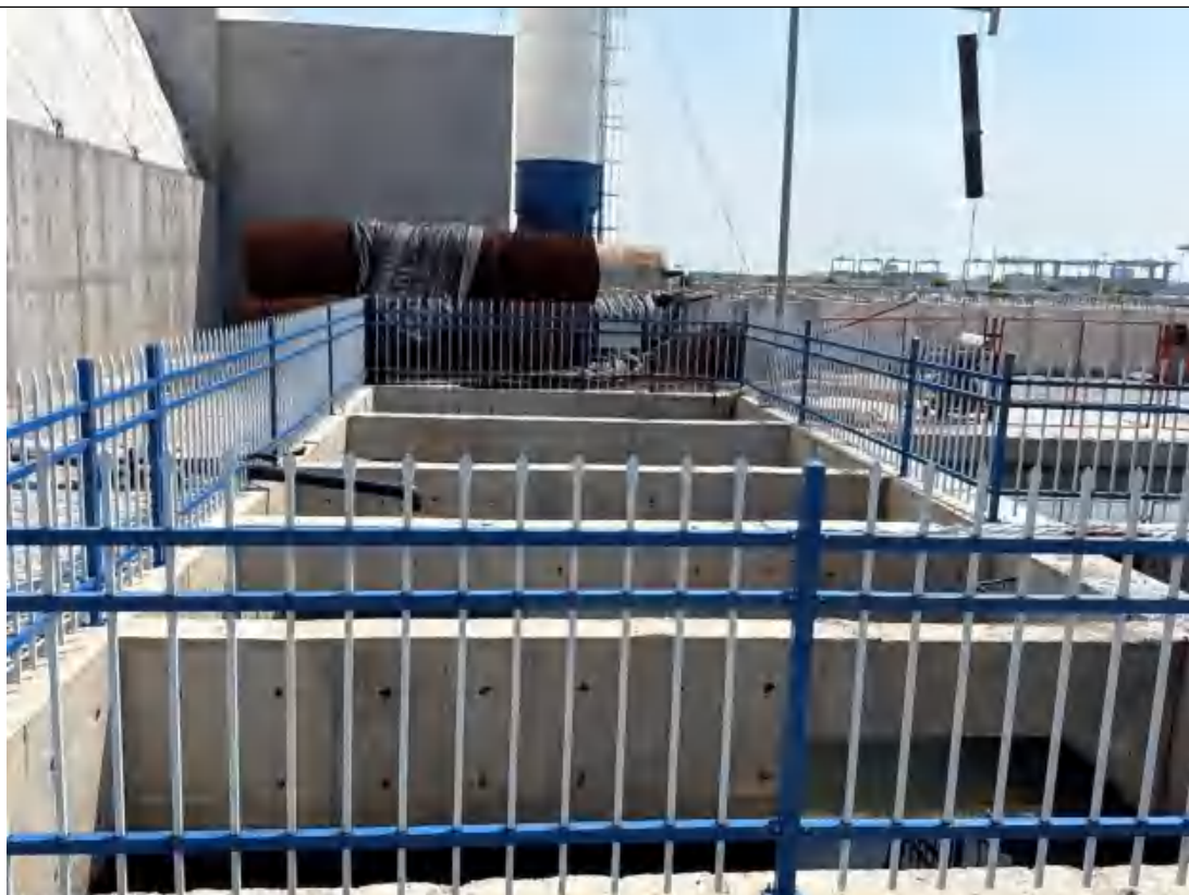
废水沉淀池组 2
