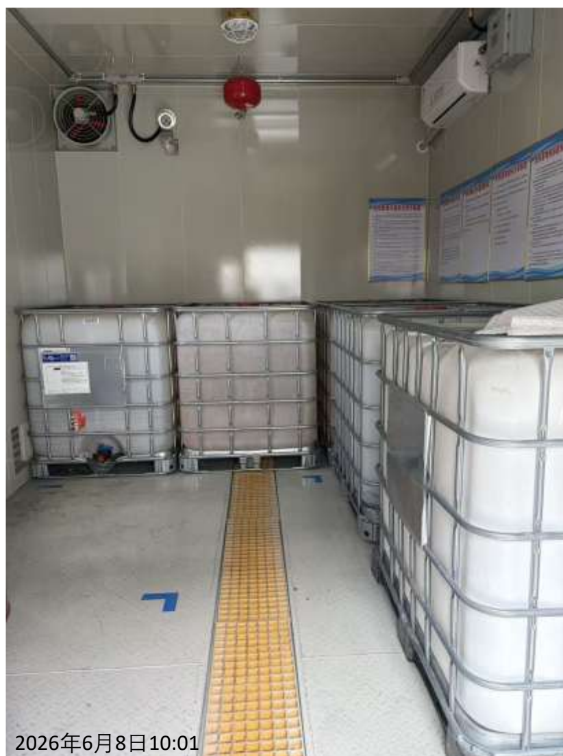
图4-2 项目危废暂存间
