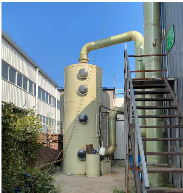
图 4.1-6 项目废气处理措施图
