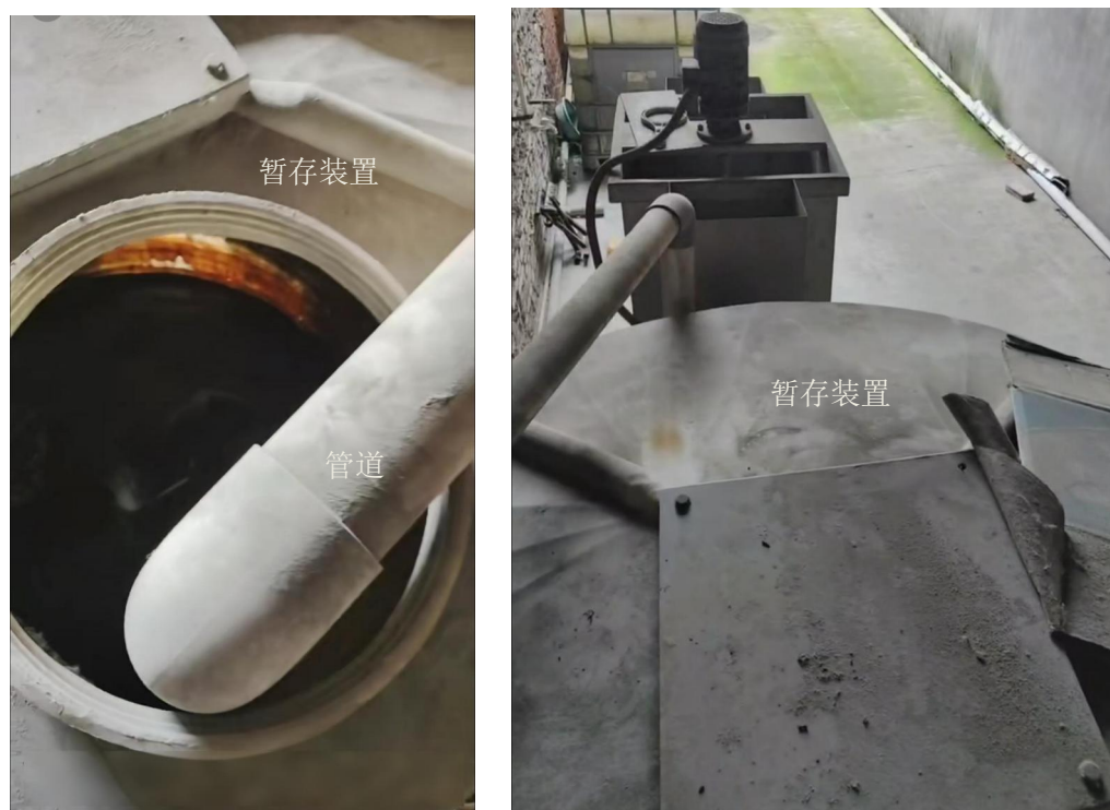
图 4.1-2 生产废水/废液的暂存装置
