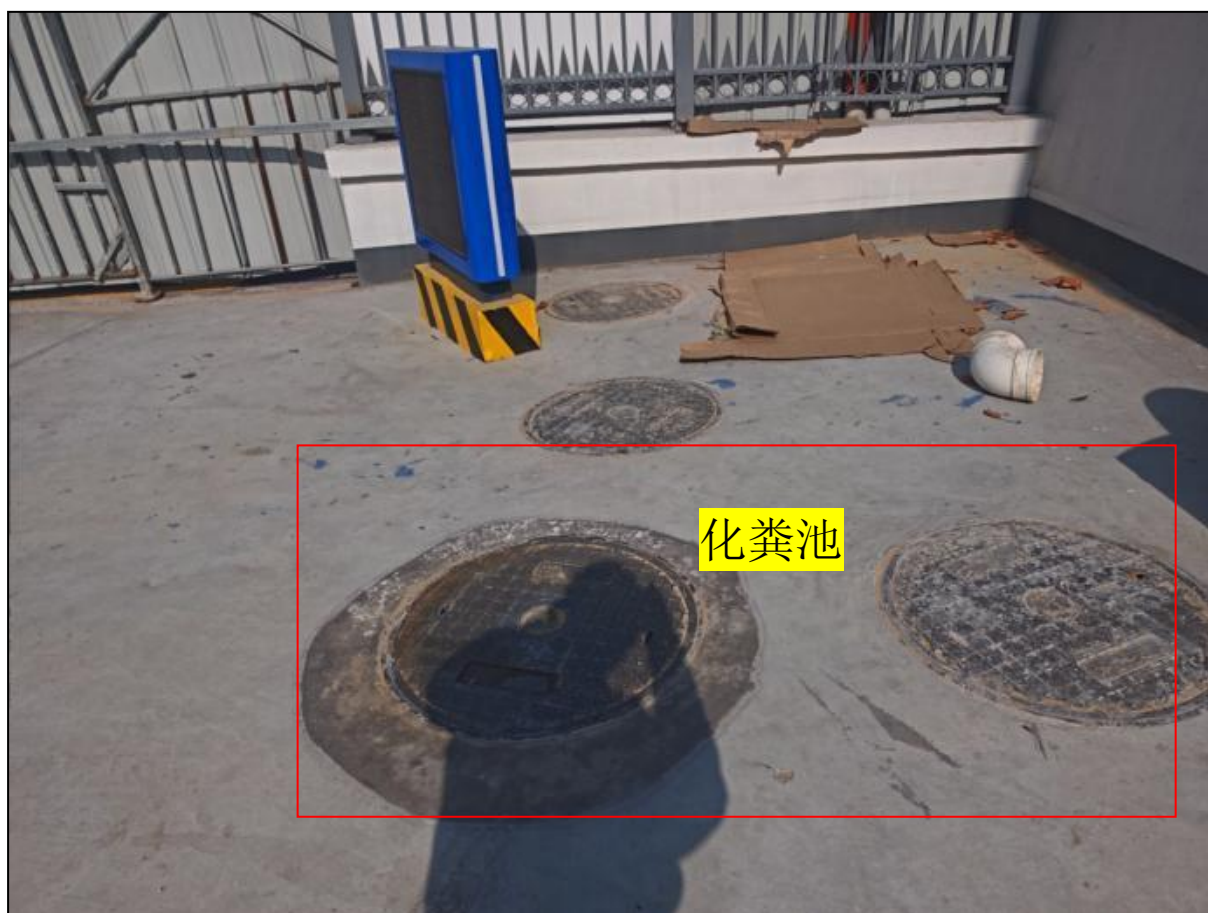
图 4-2 污水处理设施
