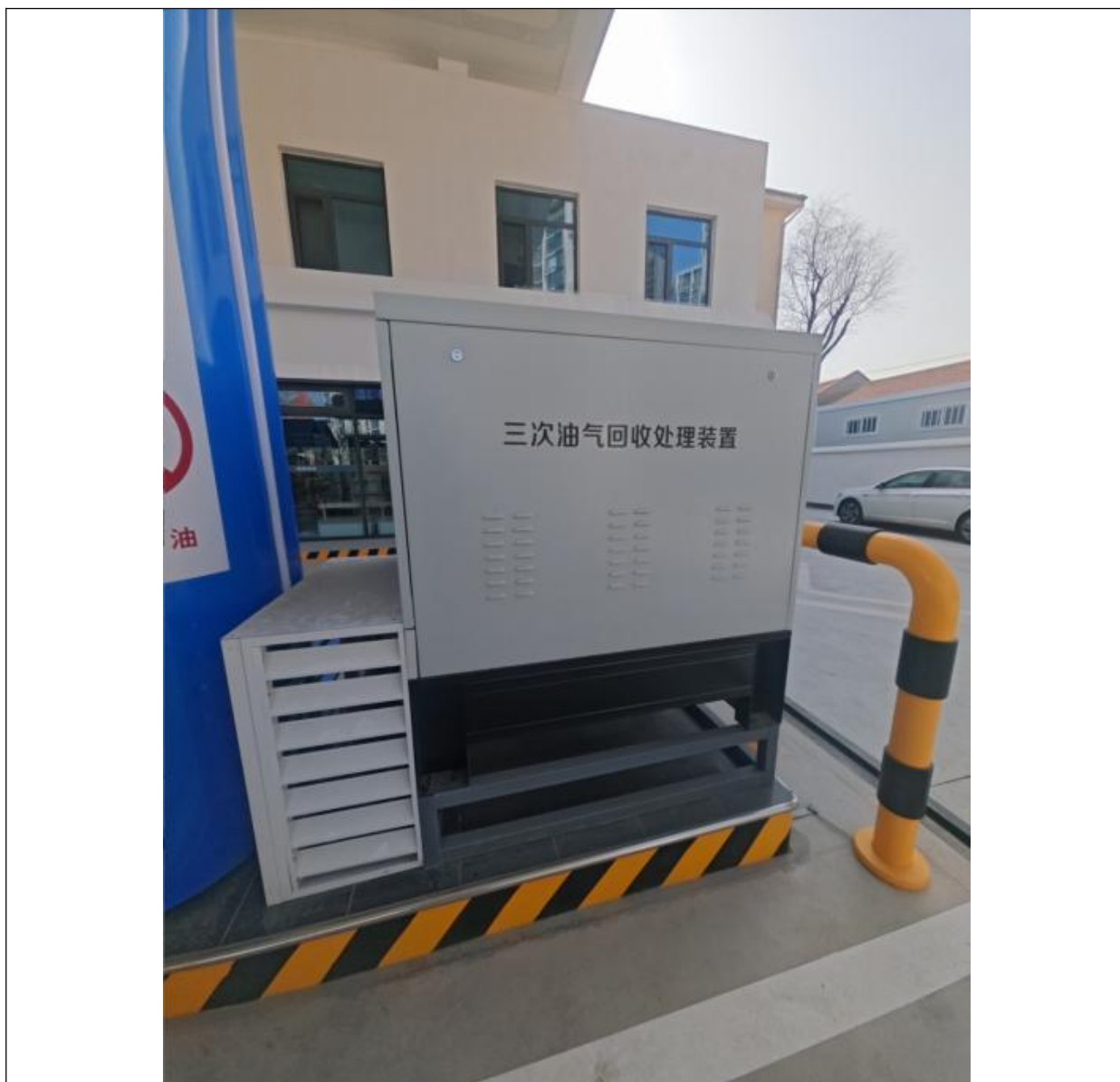
图 4-1 三次油气回收装置
