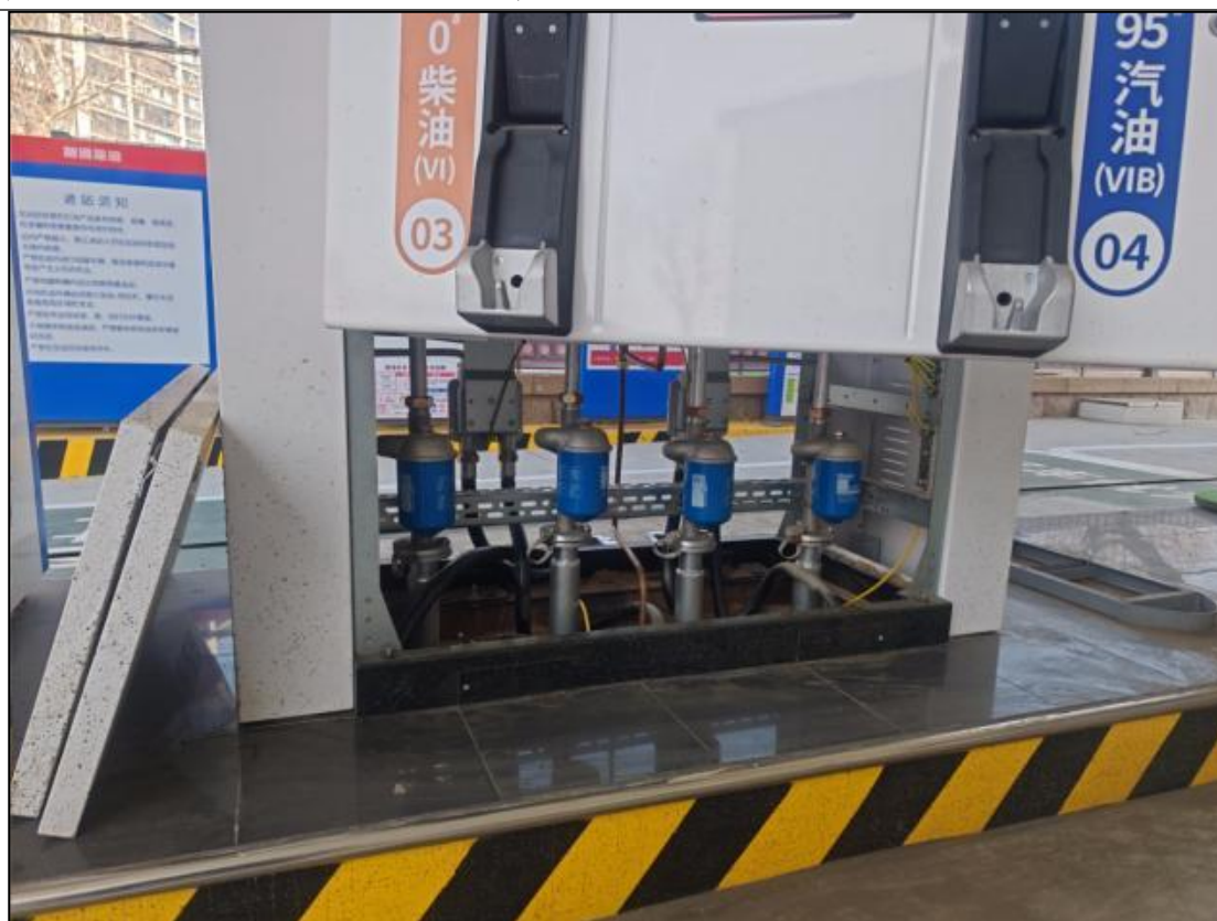
加油枪油气回收设施
