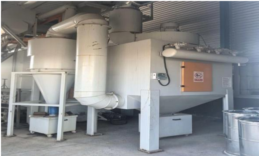
抛丸除尘措施
