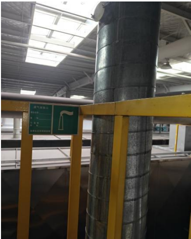
电泳废气排放标识
