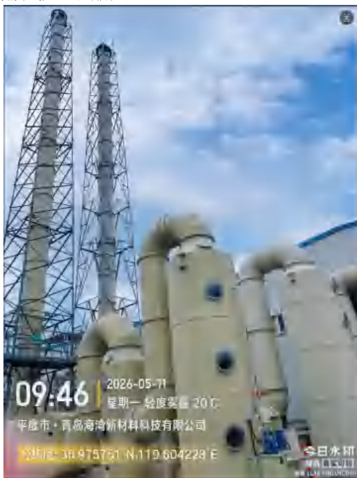
图 4.1-1 项目 2 套“碱液喷淋+除雾器+活性炭吸附”及排气筒
