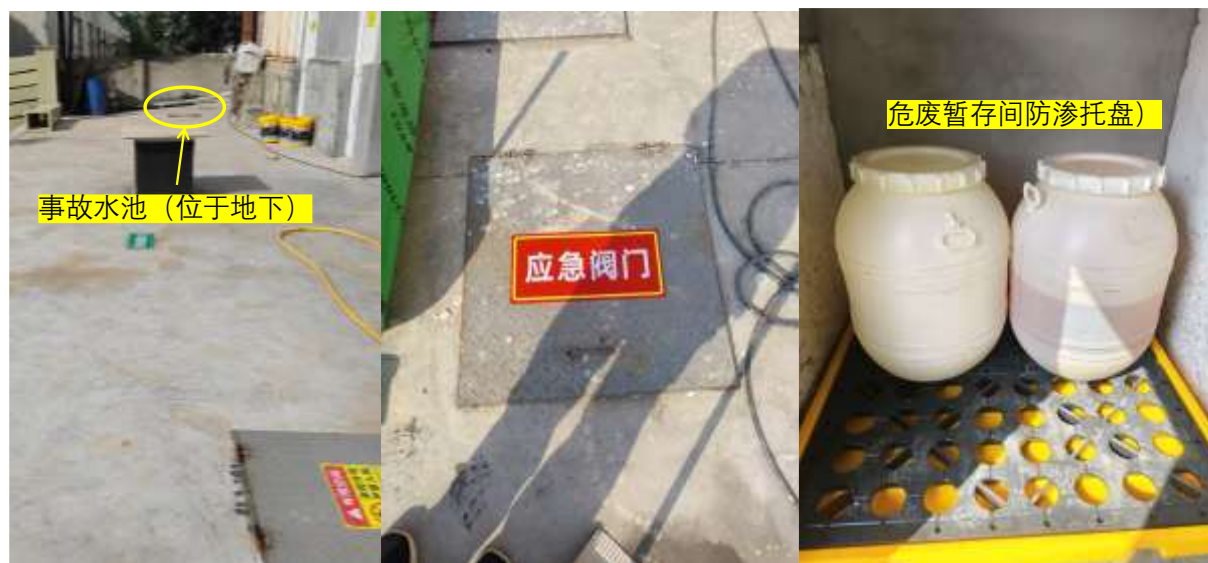
图4-4 项目事故水池及雨水口截断阀
