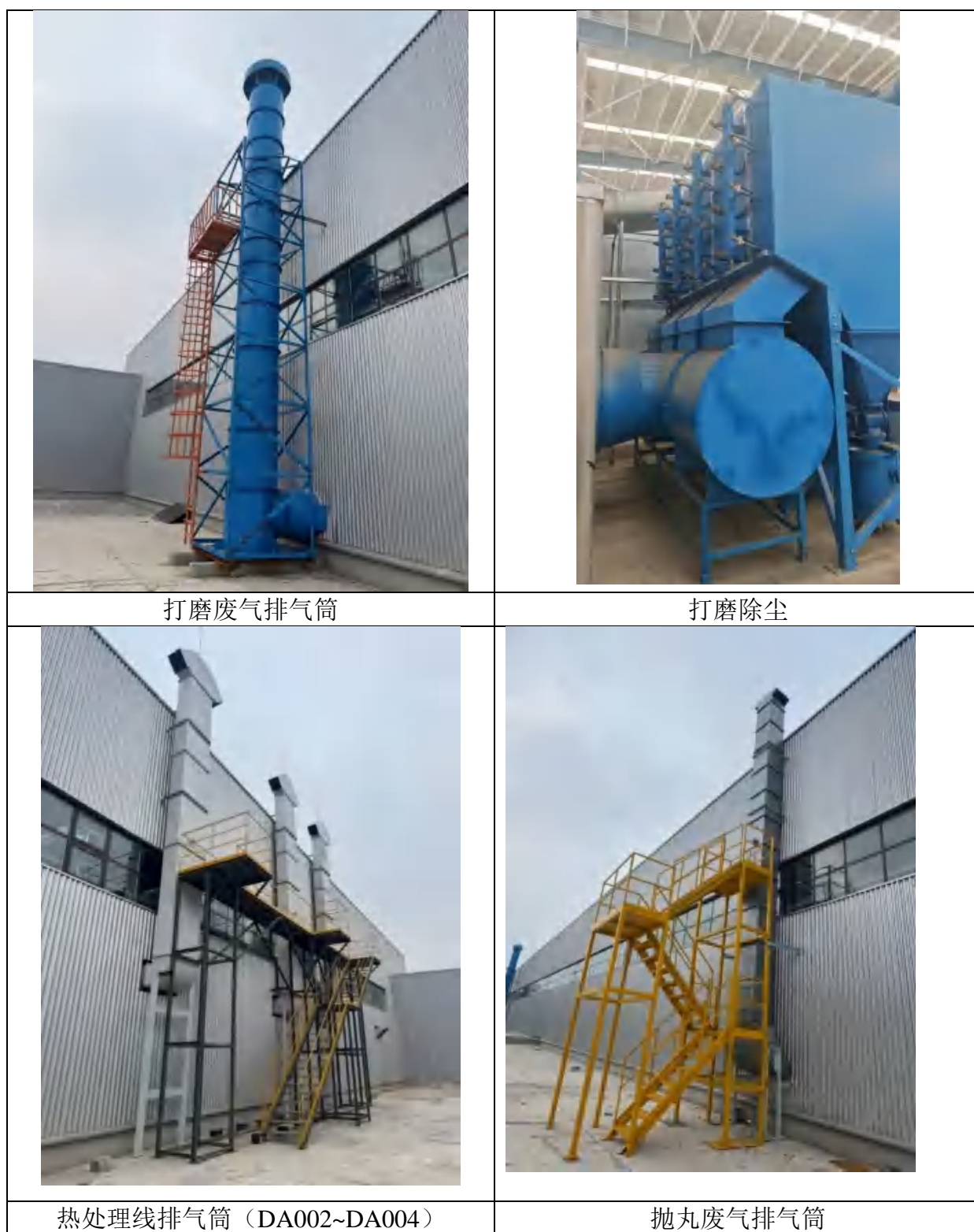
图 4.1-1 项目废气收集处理设施
