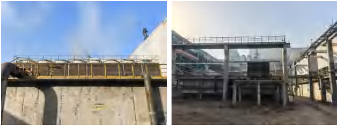
图 4.1-3 废水处理设施
