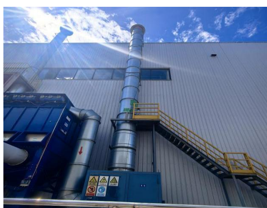
固化炉废气排放口 P5
