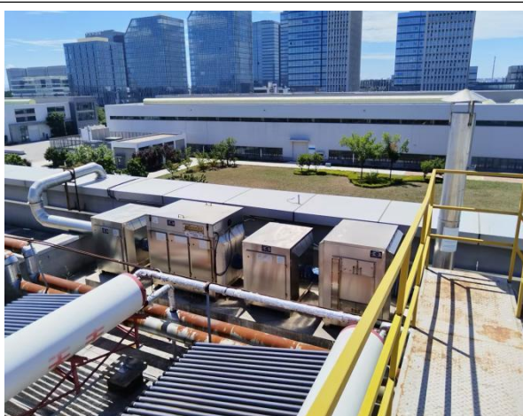
质量和外形轮廓检测废气排放管线
