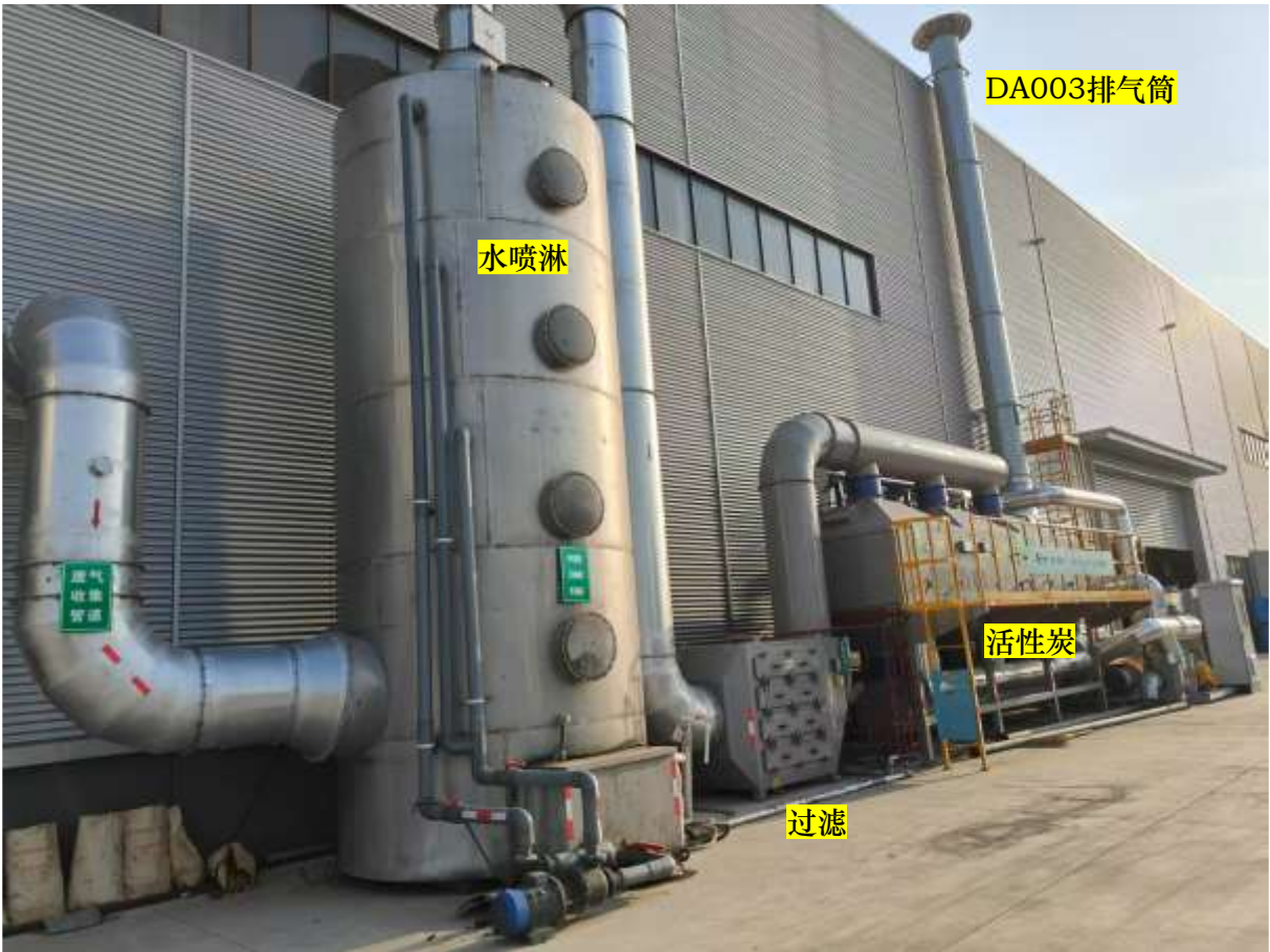
水喷淋+干式过滤+活性炭吸附/脱附-催化燃烧装置
