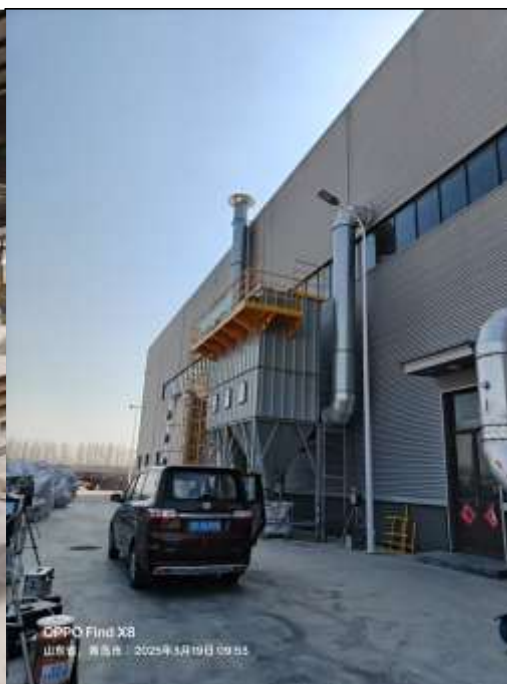
布袋除尘器及排气筒P2 (DA002)
