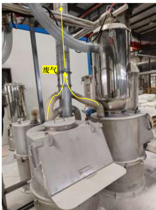
挤出线投料粉尘负压收集管道
