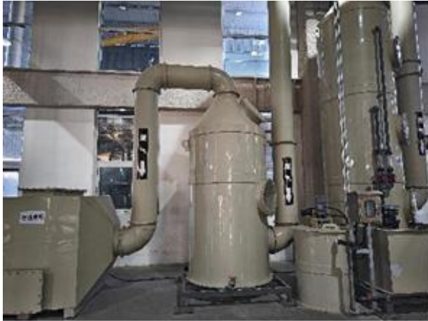
碱喷淋+活性炭吸附装置
