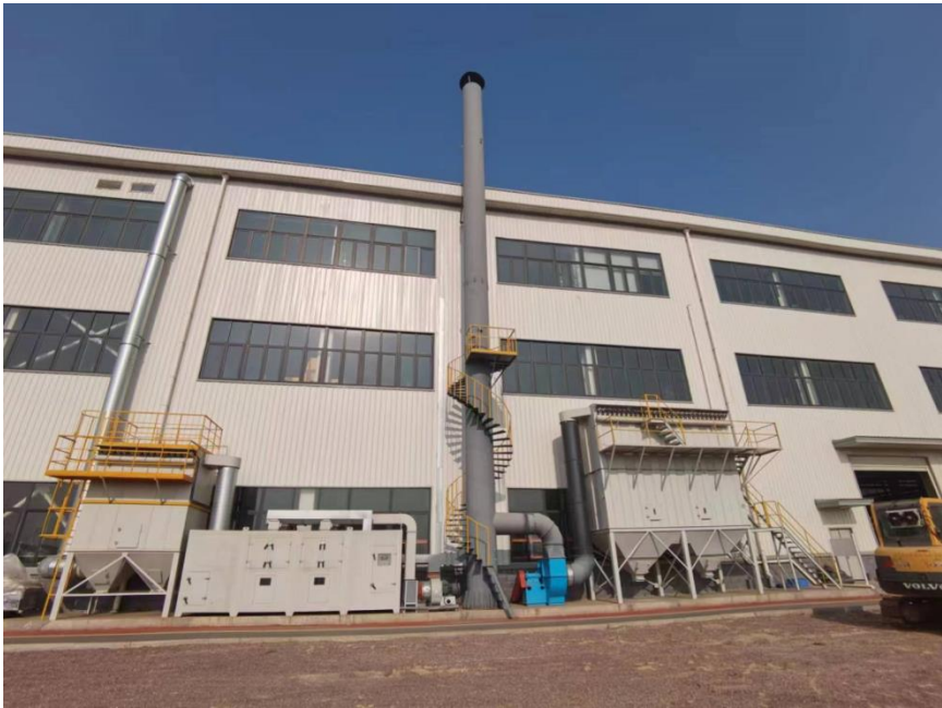
图 4.1-2 项目废气收集处理设施
