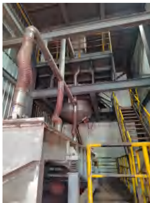
振动筛分粉碎废气处理设施 布袋除尘器
