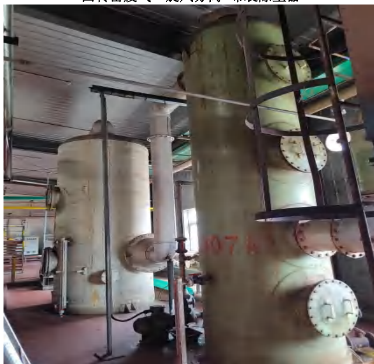
回转窑废气 两级水喷淋塔
