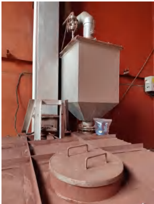
上料废气处理设施
