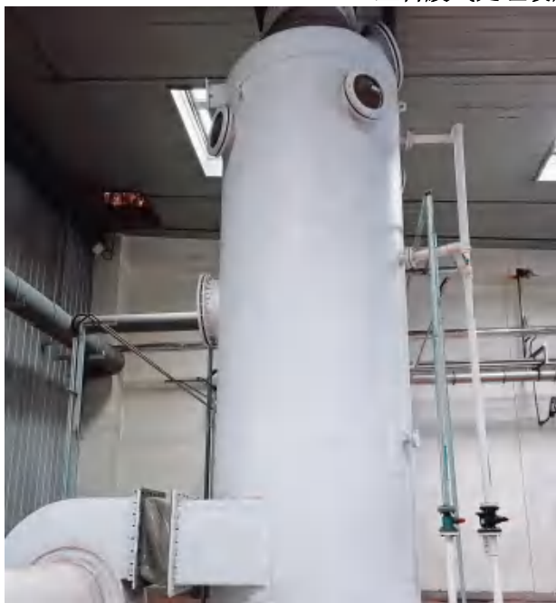
水喷淋塔（依托现有）
