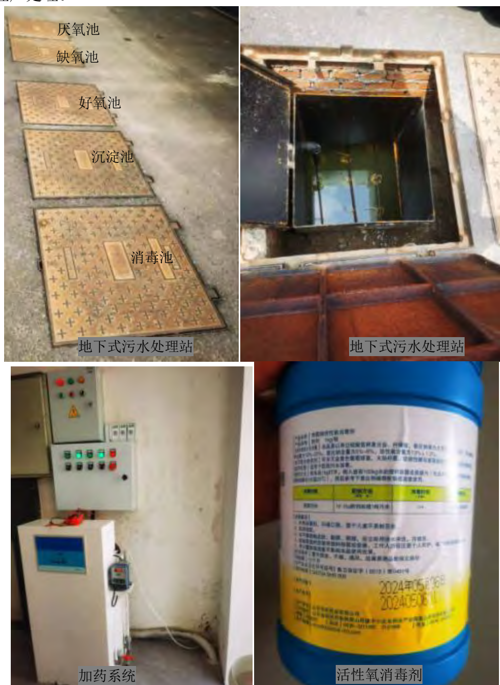
图 4.1-1 污水处理站及加药系统照片
